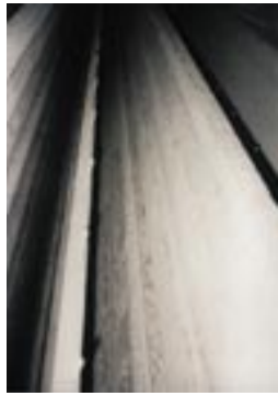
Zdj. nr 3. Narosty pyłu na elektrodach o grubości od 3 do 6 mm wymieszane z sadzą trudne do usunięcia przez układy strzepujące
