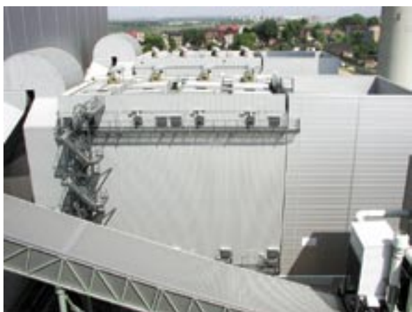
Elektrofiltry zainstalowane w EC ELCHO-Chorzów
