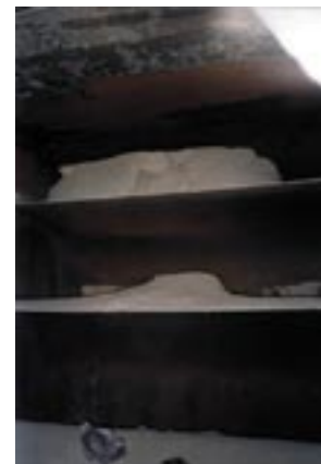
Zdj. nr 5. Narosty pyłu na kierownicach kanału dolotowego
