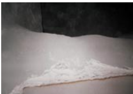
Zdj. nr 6. Narosty pyłu w kanale wylotowym
