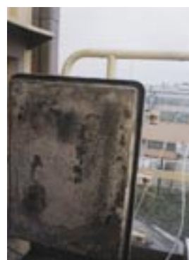
Zdj. nr 2. Korozja pokrywy włącznika świadcząca o złym zamknięciu włączników
